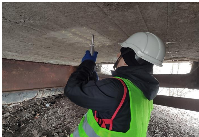
Рисунок 19 — Процес визначення міцності бетону для монолітного бетону плити проїзної частини по середині довжини консолі К(2-3)
